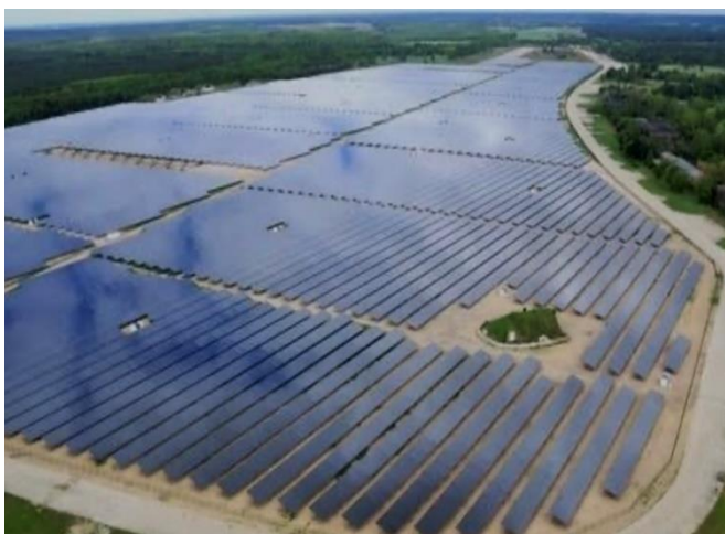
Foto 19: Parque de energia solar
