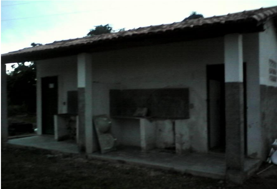
Figura 09: Prédio danificado da escola Estadual calunga II
